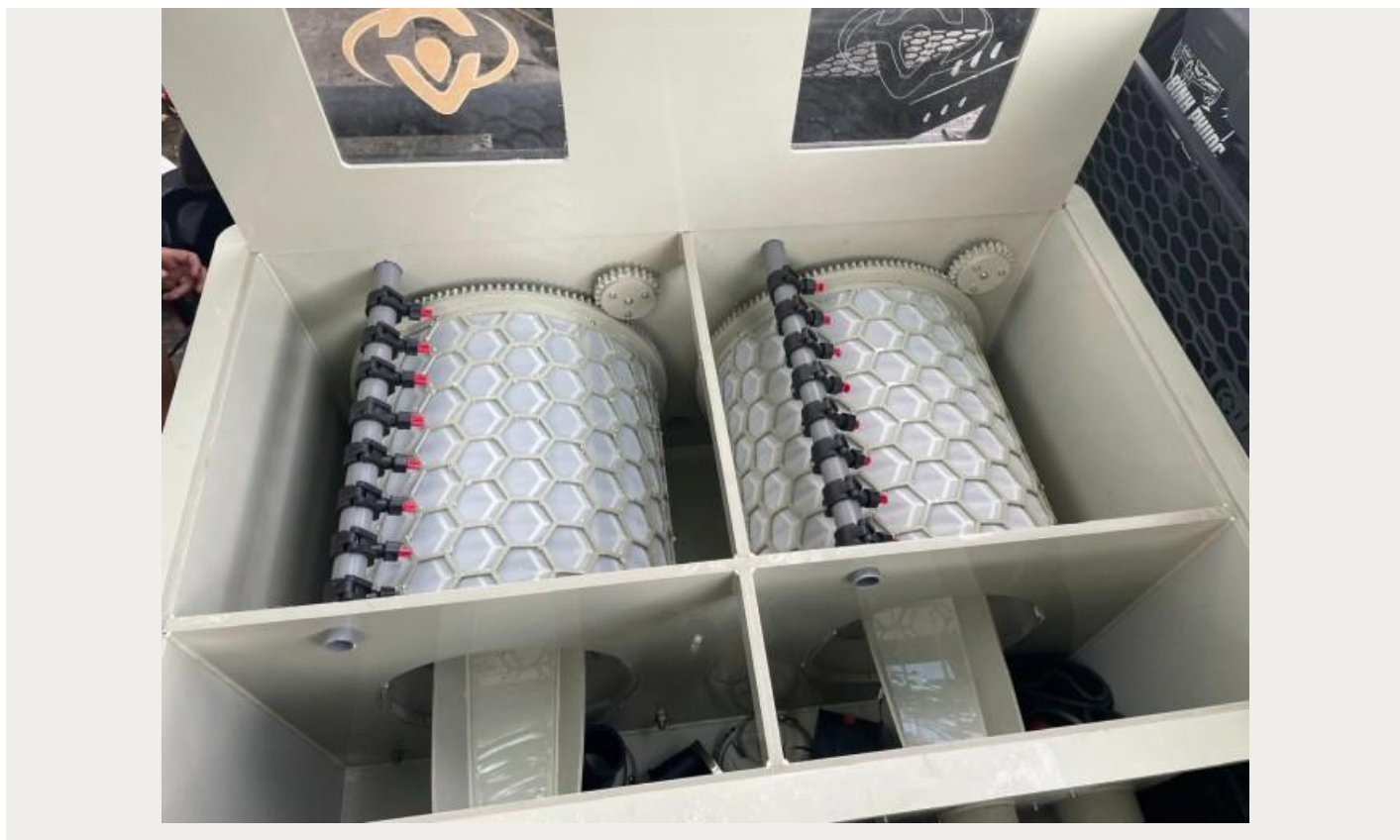
Thiết bị lọc cơ học của hệ thống. Ảnh: NVCC
