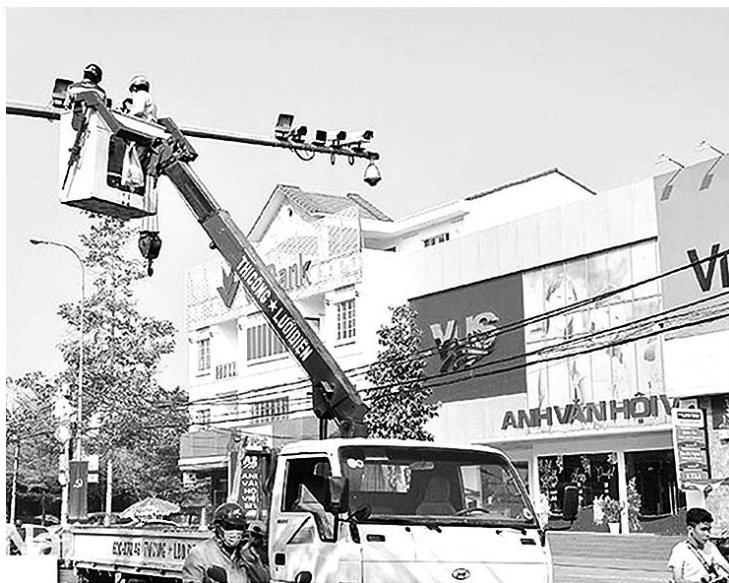
Hệ thống các camera giám sát giao thông trên đường Võ Thị Sáu (đoạn qua P.Quyết Thắng, TP.Biên Hòa)
