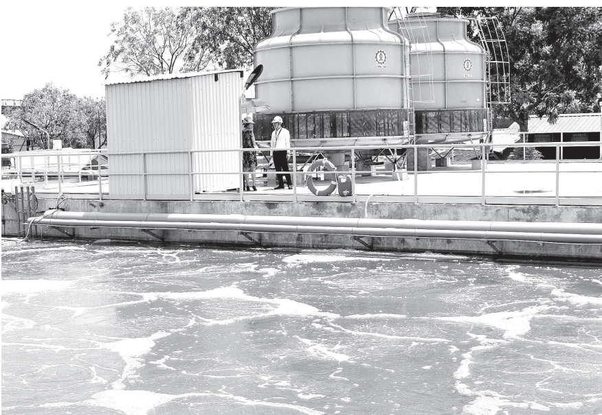
Khu xử lý nước thải có lắp đặt quan trắc tự động tại Công ty CPHH Vedan Việt Nam
